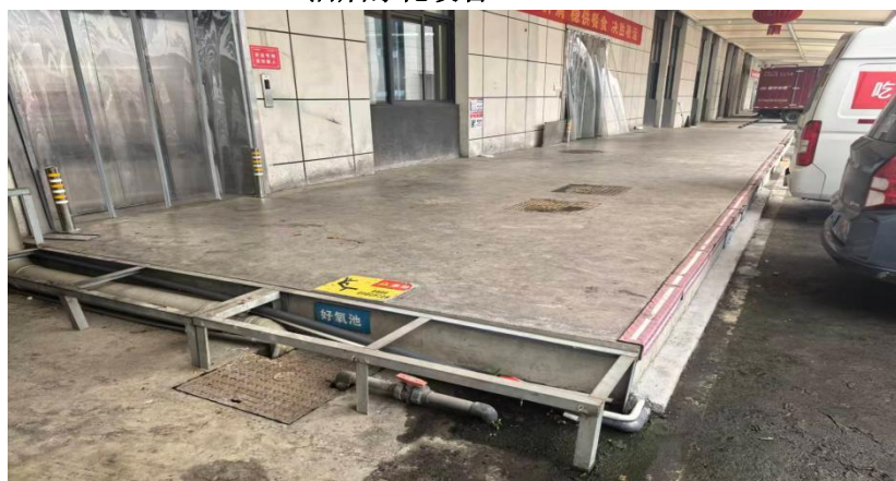
处理设施（地下）
