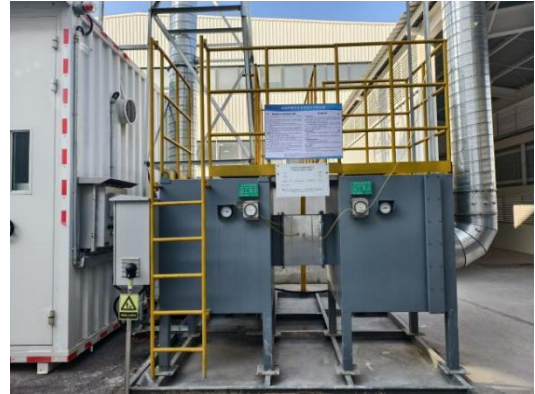
危废库废气治理设施
