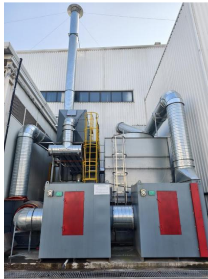
PUR 胶涂胶、烘干固化废气，AB 胶涂胶、加热压合废气、天然气燃烧废气治理设施
