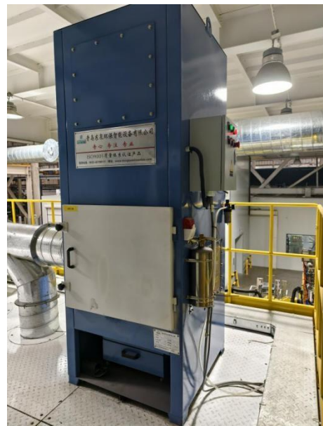
激光焊接烟尘治理设施
