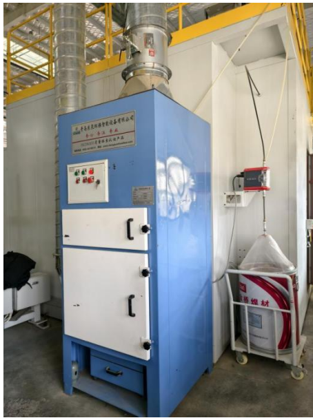
弧焊烟尘治理设施
