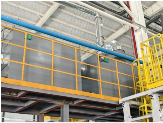
结构胶涂胶废气、常温固化废气治理设施
