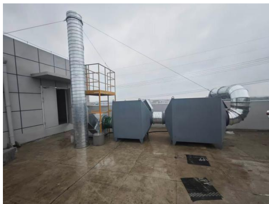
封膜废气环保设施
