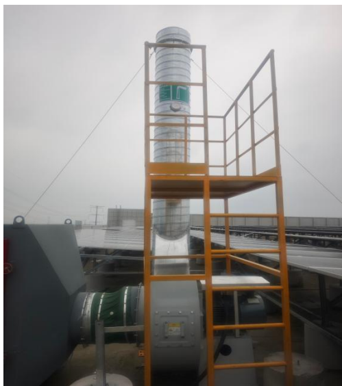
封膜废气排气筒
